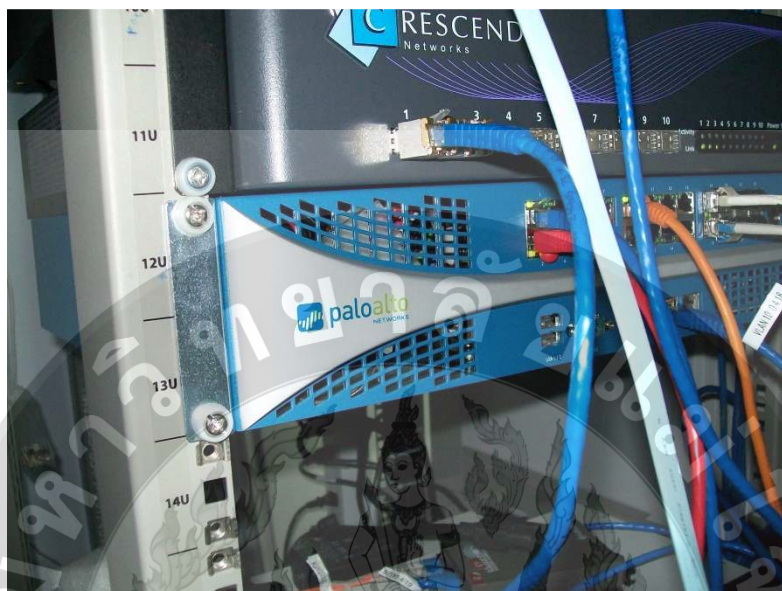
ภาพที่ 10 แสดงอุปกรณ์ระบบบริหารจัดการช่องสัญญาณและการป้องกันการบุกรุกโจมตีทางเครือข่าย ยี่ห้อ Palo alto รุ่น PA-4050
