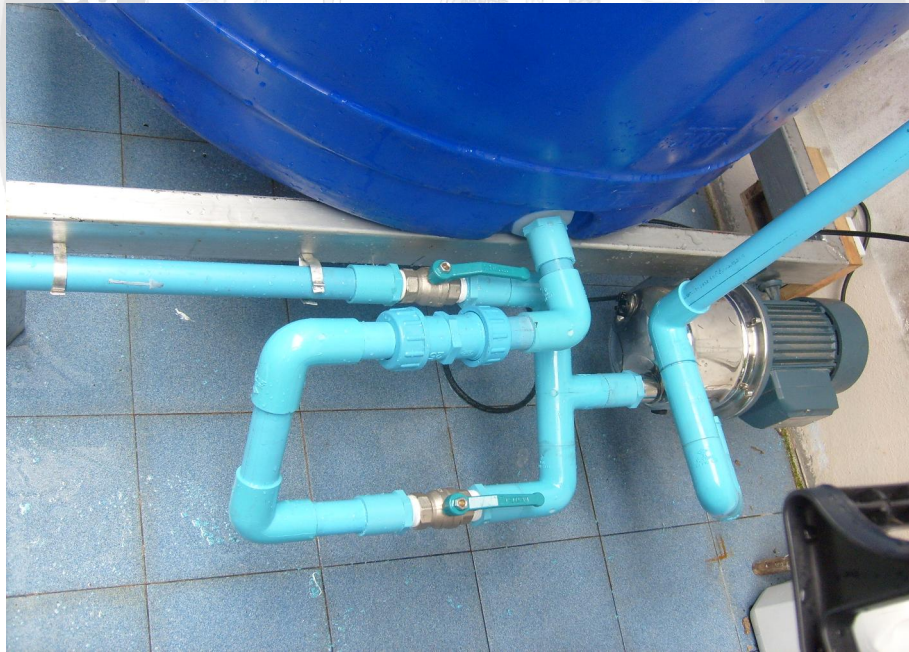
ภาพภาคผนวกที่ 11ท่อช่องทางรับของเหลวจากภายในและภายนอก
